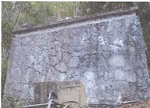
TANQUE DE ALMACENAMIENTO CENTRO MAV-EDNH-0006
