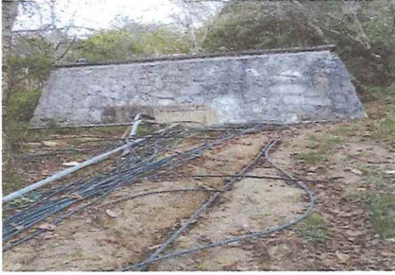
TANQUE DE ALMACENAMIENTO
