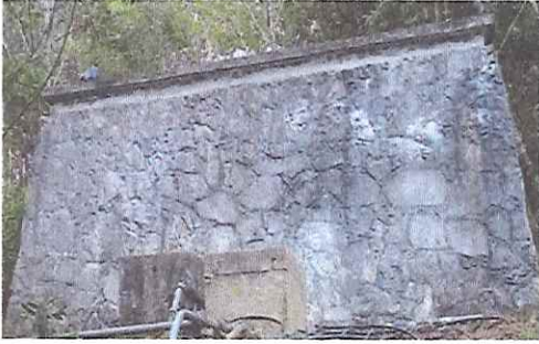
TANQUE DE ALMACENAMIENTO CENTRO
