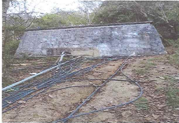
TANQUE DE ALMACENAMIENTO
