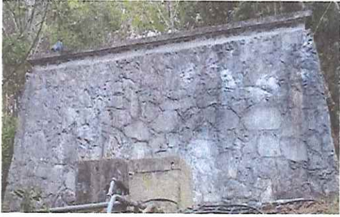
TANQUE DE ALMACENAMIENTO CENTRO
