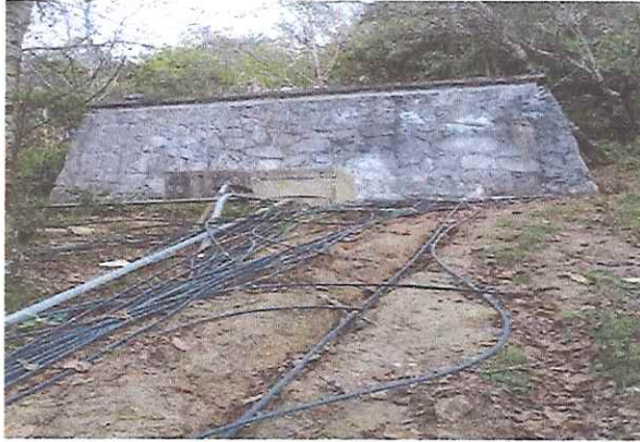
TANQUE DE ALMACENAMIENTO
